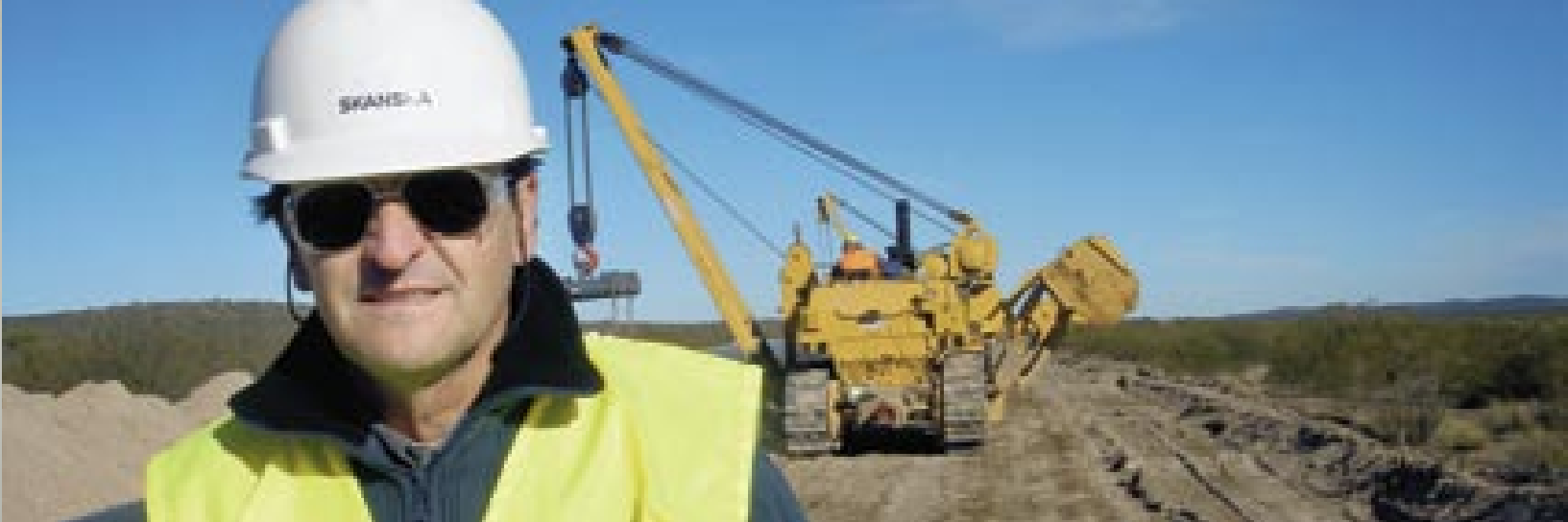
I Latinamerika fokuserar Skanska på kunder inom olje-, gas- och energisektorn. Ett av de större nybyggnadsprojekten som slutfördes under 2005 är en 153 kilometer lång pipeline för gas i södra i Argentina. Miguel Ortiz är Skanskas projektledare.
