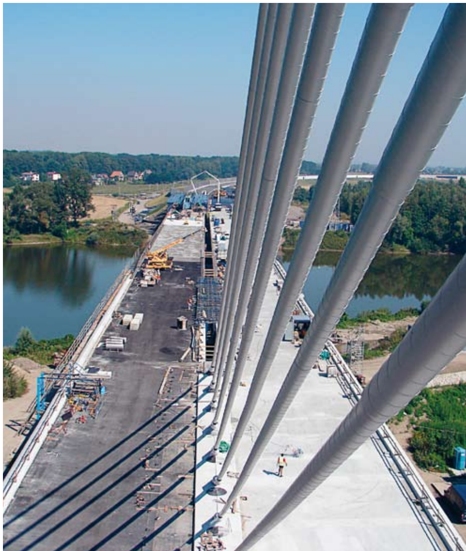
I Tjeckien genomför Skanska en lång rad projekt inom transportinfrastruktur. Bland annat sker en stor uppgradering av vägnätet. Denna bro ingår i utbyggnaden av motorvägen D47 vid Ostrava i östra Tjeckien.
