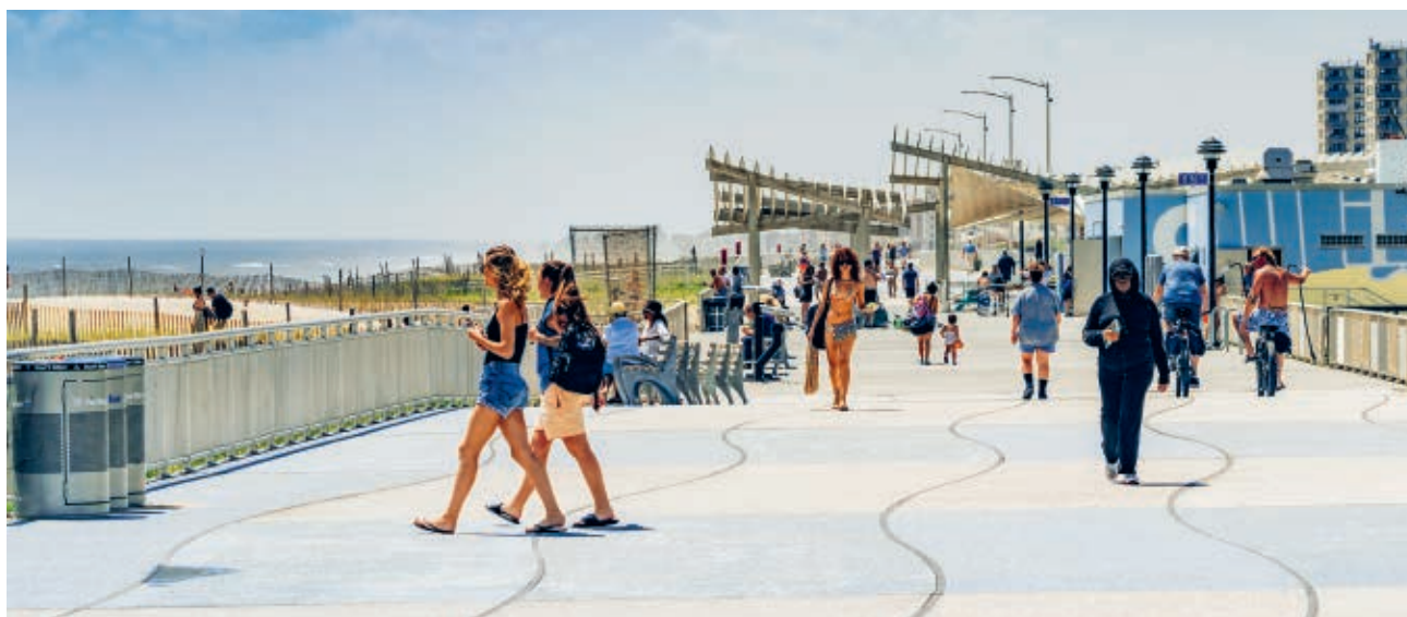
Skanska har återbyggt strandpromenaden Rockaway Beach Boardwalk i New York, USA, som skadades i orkanen Sandy 2012. Den nya strandpromenaden har höjts upp över den 100-åriga flodbädden och fått ett stålförstärkt betongdäck.
