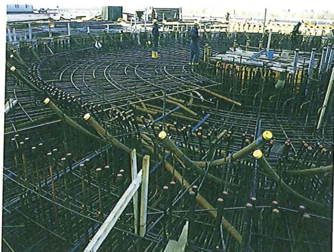
På Barsebäcksverkets säkerhetsanläggning "Filtra" har ISAB utfört en komplicerad spännarmering på totalåtagande.
